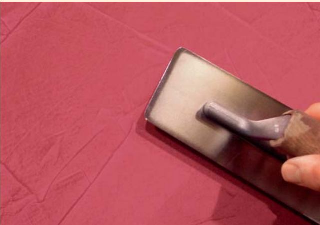
5) Nach ca. 20-30 Minuten wird die Oberfläche mit einer Venezianerkelle poliert (verpresst), anfangs nur leichten Druck ausüben, später den Druck erhöhen
